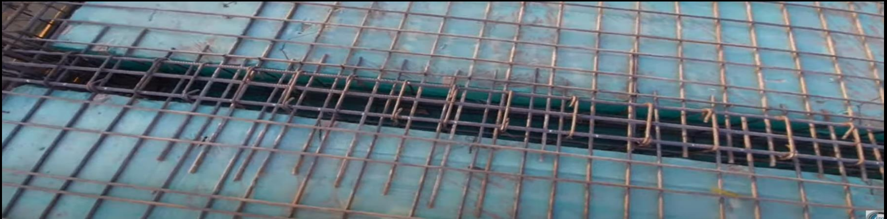
Papan cetakan bocor
